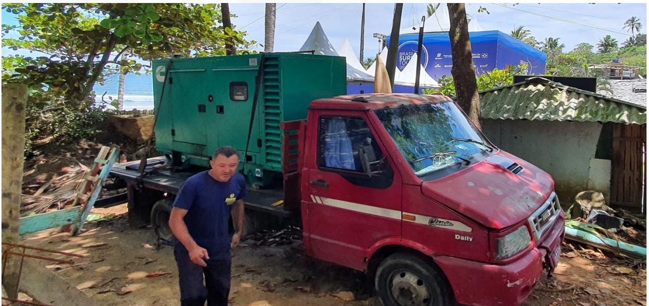
Gerador de energia
