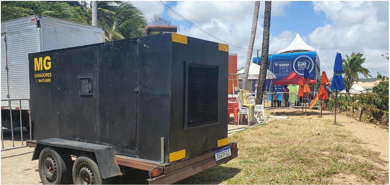
Gerador de energia
